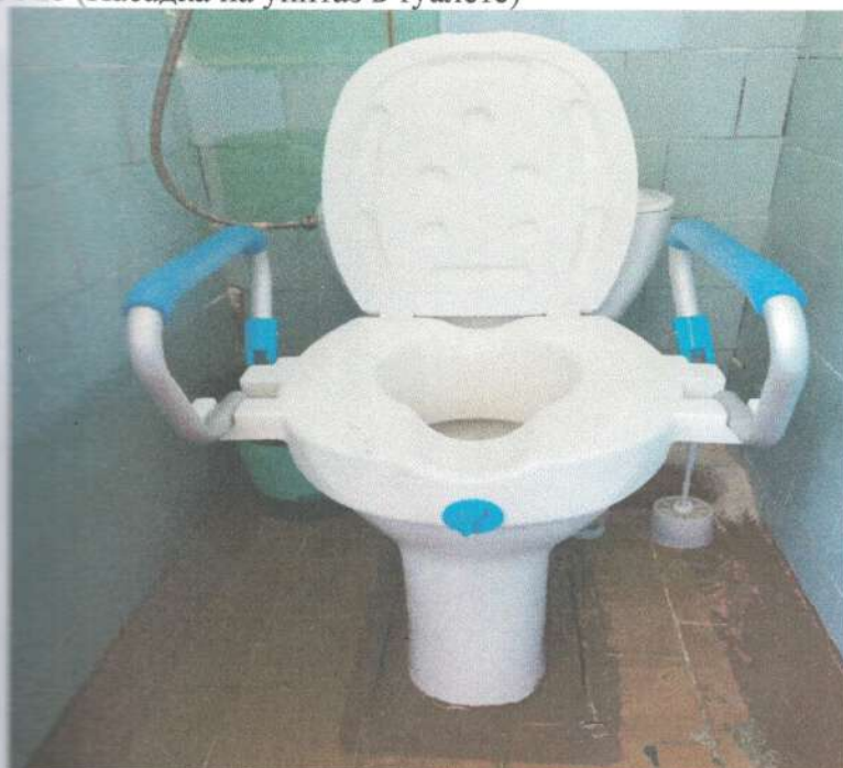
Фото №6 (Насадка на унитаз в туалете)
